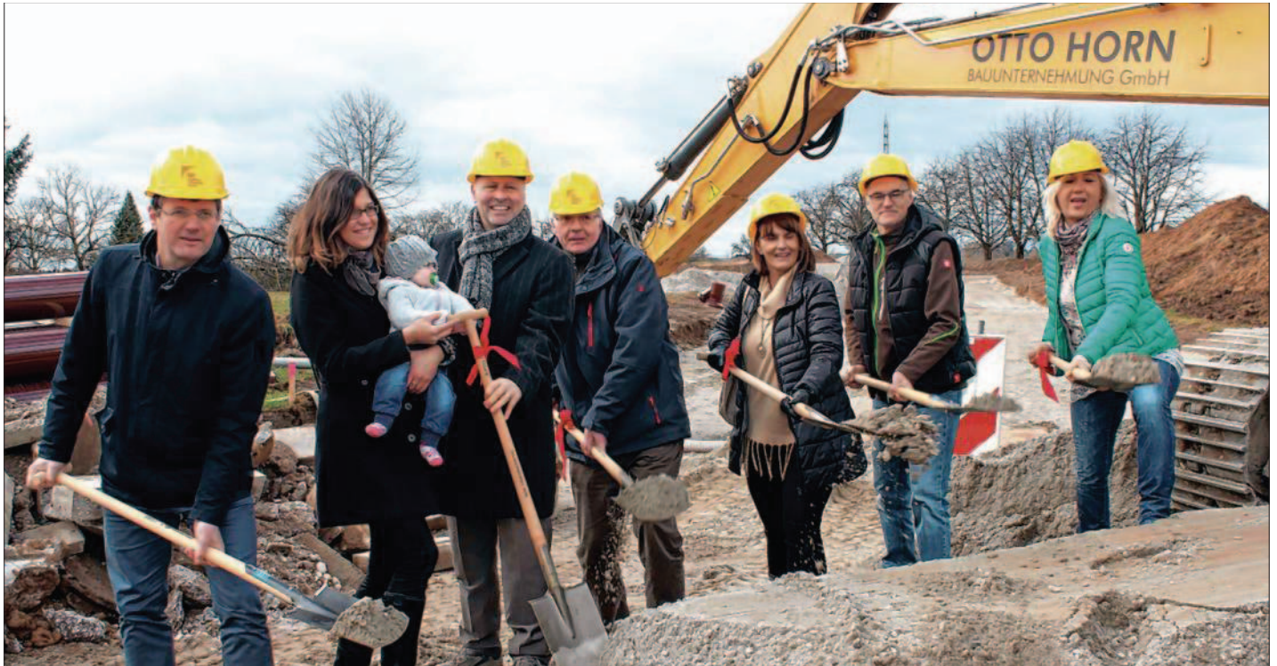
Start für das Bohlsbacher Neubaugebiet »Westlich der Okenstraße« (von links): Oliver Martini, eine Bauherrin, Heiner Benetz, Ralf Siggelkow, Ortsvorsteherin Nicole Kränkel-Schwarz, Bauunternehmer Michael Horn und Claudia Störk von der Erschließungsgemeinschaft.
